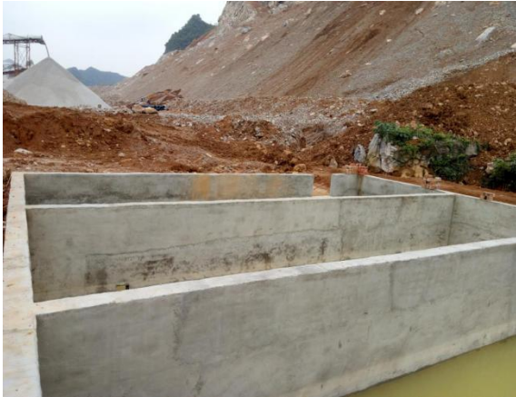
初期雨水沉淀池
