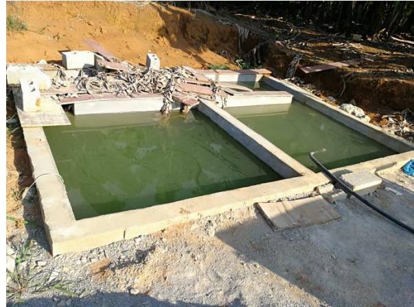
洗车废水沉淀池
