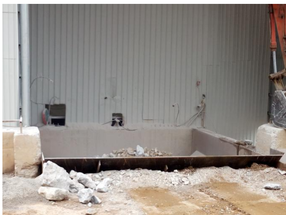
下料口喷淋措施
