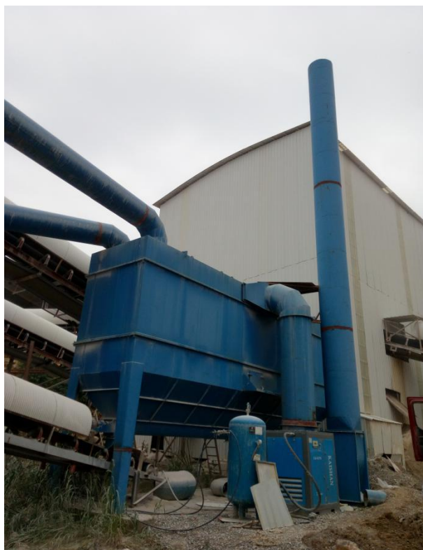
布袋除尘及排气筒
