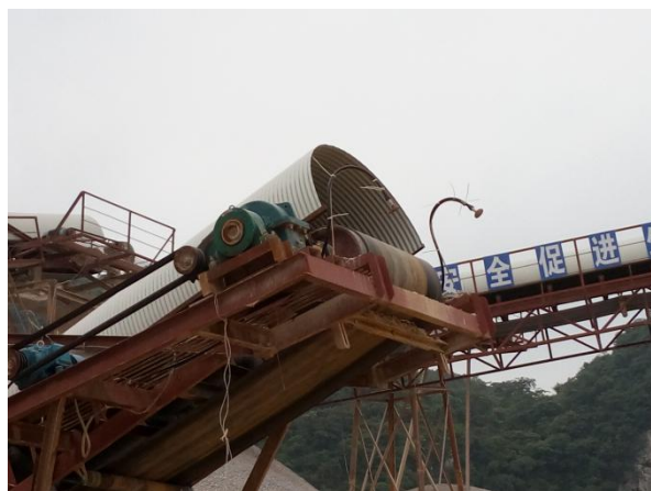
装车卸料口喷淋措施
