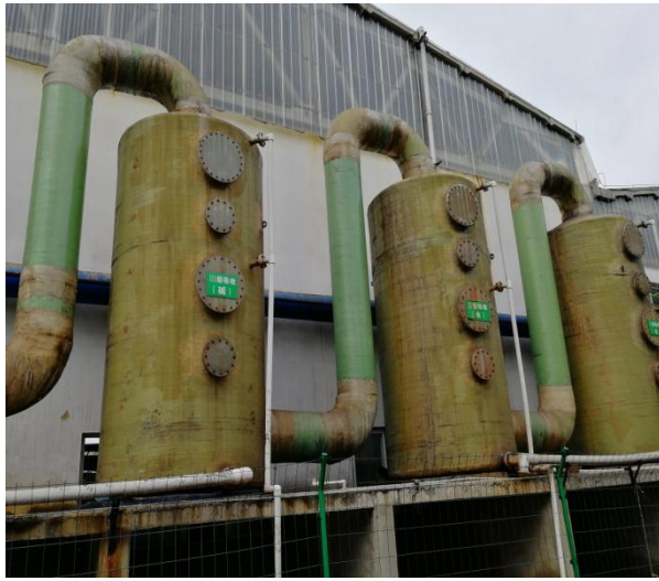
稀碱液喷淋吸收系统
