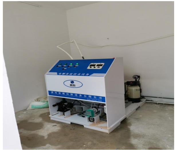
污水处理站设备
