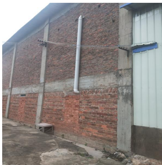
2#废矿物油区排气筒
