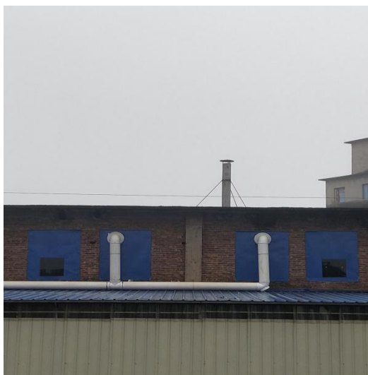
1#废铅电池区排气筒
