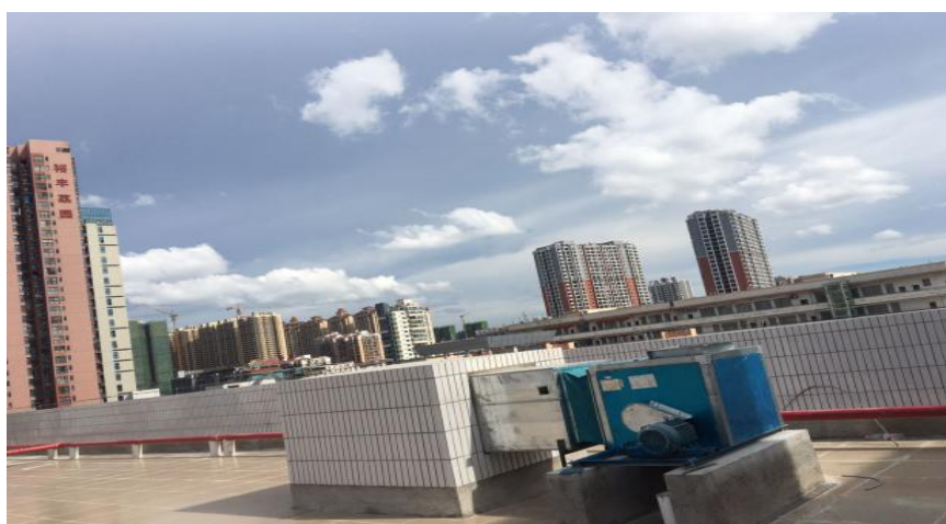
实验室楼顶废气排放口
