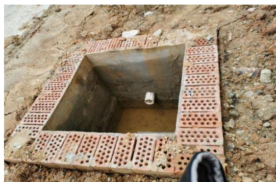
施工期酸碱中和池
