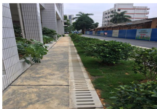
运营期雨水排水沟
